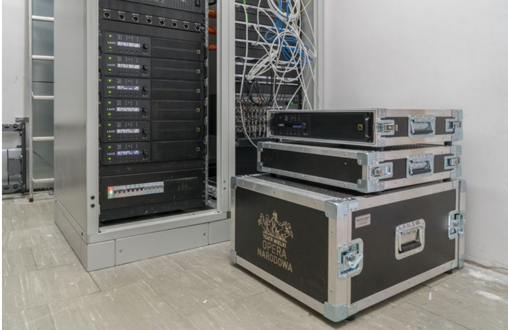
Wszystkie wymienione urządzenia głośnikowe zasilane ze wzmacniaczy L-Acoustics LA4X, z których większość zainstalowana jest w szafie teletechnicznej znajdującej się w amplifikatorni.
